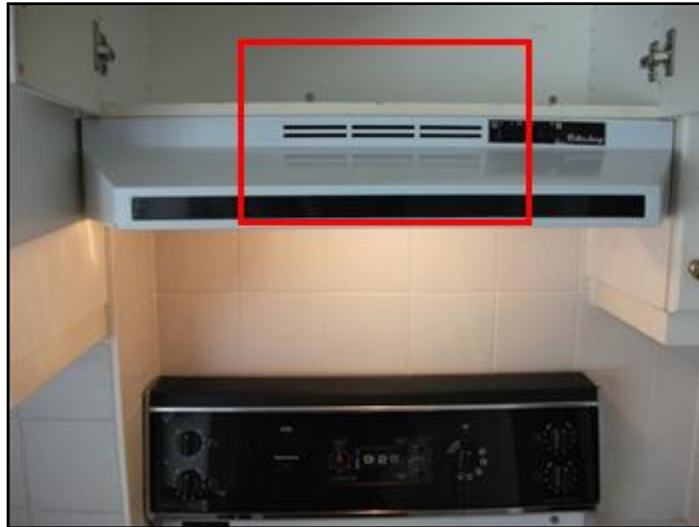
17. Kitchen Hood Fan
