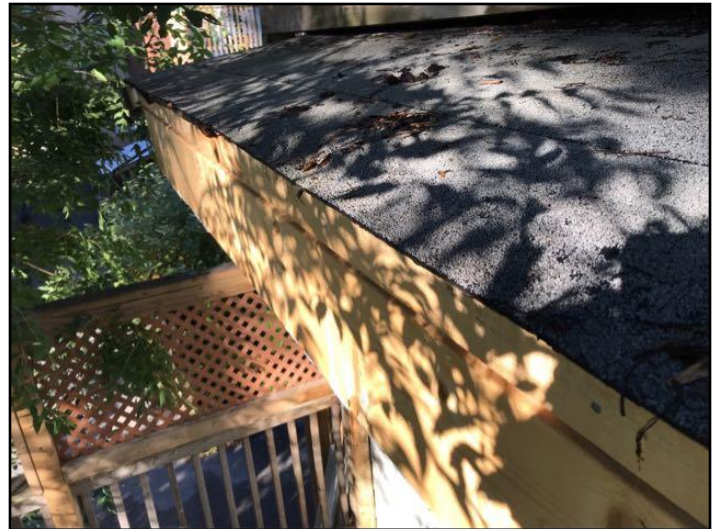
Drip edge - missing
