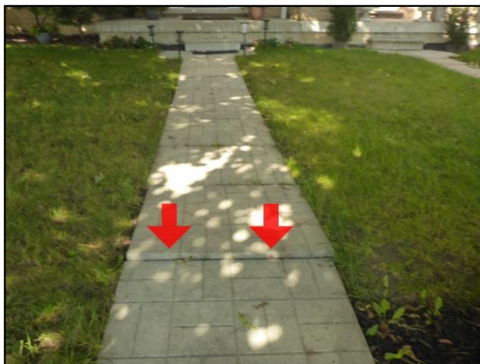
Uneven (trip hazard)
