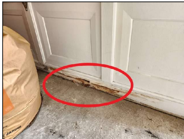
27. Deterioration, rot or rust
